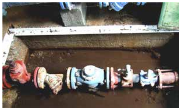
Figura 6-16 – Contador intercalado num “comboio” de acessórios sem qualquer troço reto.
