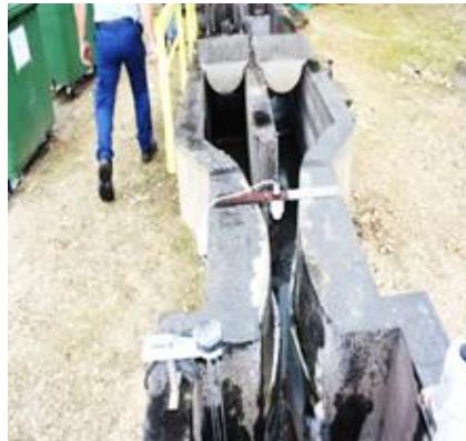
Medidor ultrassónico de nível aplicado num canal Parshall
