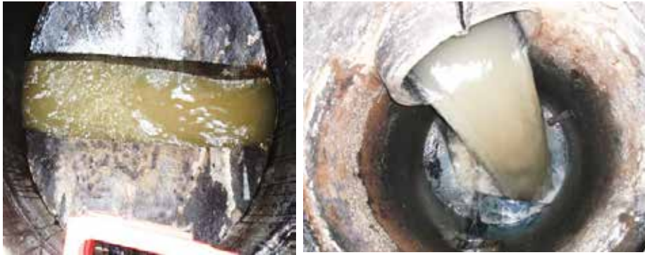
Escoamento irregular decorrente de uma caleira irregular
