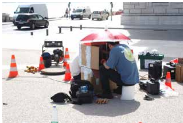
Figura 9-27 – Programação após instalação do medidor
