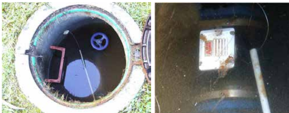
Figura 6-17 – Por vezes, os níveis freáticos da zona não deixam alternativa, mas um caudalímetro electromagnético (ainda que IP 68) dentro de água não é recomendável ... 27
