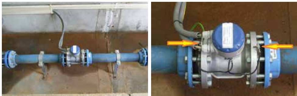
Figura 6-25 – Ligação equipotencial e à terra de um caudalímetro electromagnético, utilizando anéis equipotenciais 30
