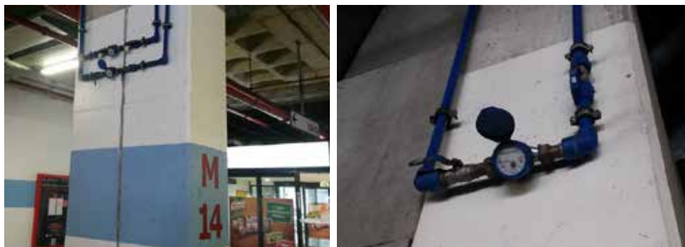
Figura 6-18 – Estacionamento de um Centro Comercial. Contadores monojacto de uso interno, dos serviços das lojas, colocados suficientemente alto para não se lhes chegar e virados para baixo para fácil leitura. 28
