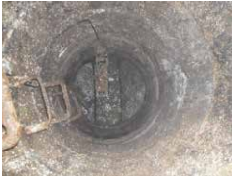
Figura 9-38 – Medidor de caudal antes da limpeza
