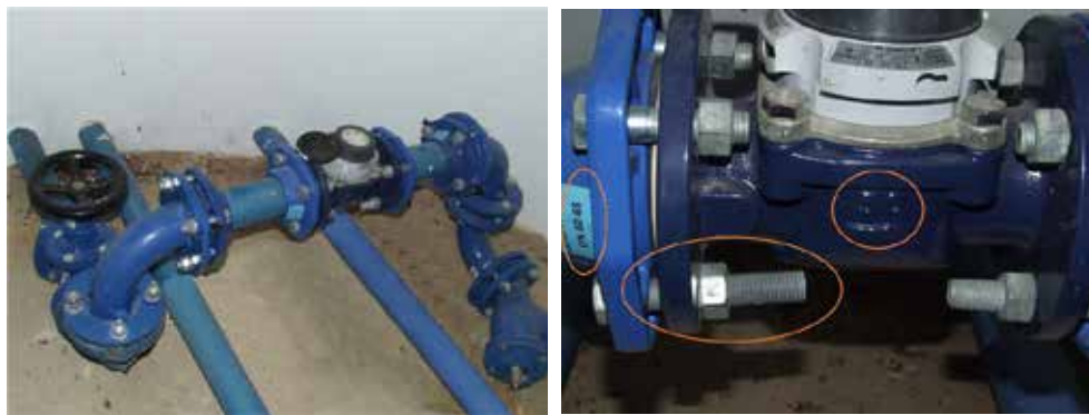
Figura 6-15 – Contador colocado em ponto alto, sem ventosa; embora disponha de troços retos, trata-se de um DN 50, montado forçadamente numa conduta DN 65, sem cones de redução (notam-se os parafusos inclinados).
