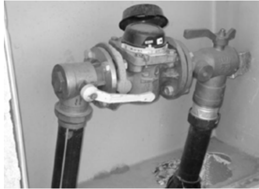
Figura 6-14 – Contador colocado num ponto alto (sem ventosa), instalado diretamente entre duas válvulas angulares, sem troços retos.
