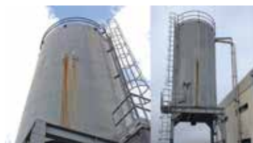
Zonas de Elevada Corrosão
