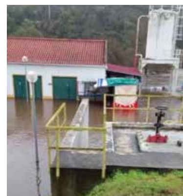
Inundação da ETAR Ponte de Sor (13 de dezembro de 2022)
