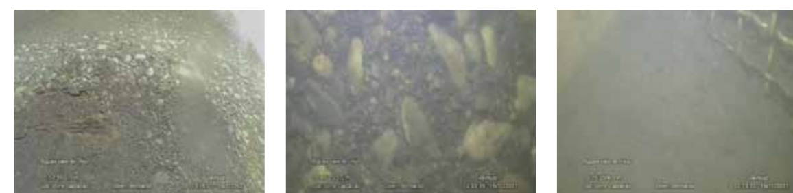
Figura 3. Desgaste da camada superficial do betão e exposição de armaduras e assoreamento da comporta à cota 183,60 m
