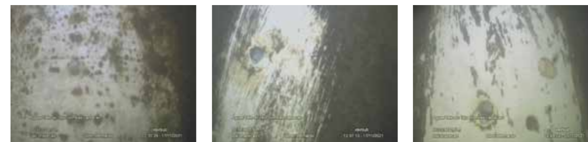
Corrosão alveolar na coluna de aspiração da bomba intermédia
