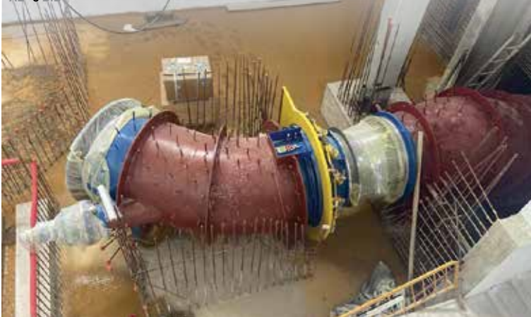
Conduta com turbina para produção de energia hidroelétrica
