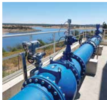
Conduta de chegada de água proveniente da Albufeira de Alqueva à entrada da ETA Monte Novo
