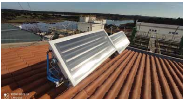
ETA de Monte Novo
